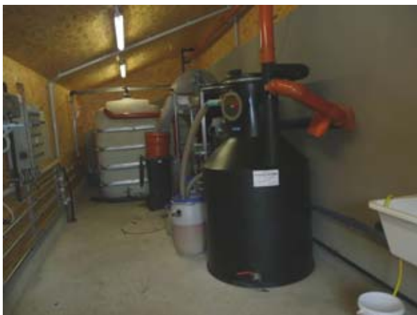
Slika 5 Prostor v stavbi čistilne naprave
